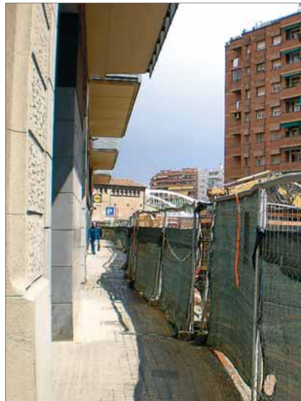
Les tanques de les obres del TGV al Clot col·locades a tocar dels portals segueixen afectant la mobilitat dels veïns ■ AVUI
